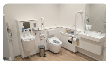
SPOT 4 2号館(新館)1階 右勝手 入口自動ドア/手すり/鏡付き汚物流し 着替え台/鏡付き手洗い/ベビーチェア おむつ換え台
