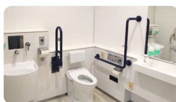
SPOT 3 1号館14階 右勝手 入口自動ドア/手すり/鏡付き汚物流し 着替え台/鏡付き手洗い/ベビーチェア おむつ換え台
