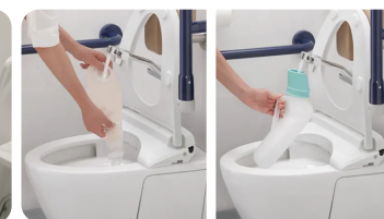
SPOT 10-11 2号館(新館)2階 男子トイレ・女子トイレ パウチ・しびん洗浄水栓 ※1ブースに設置あり
